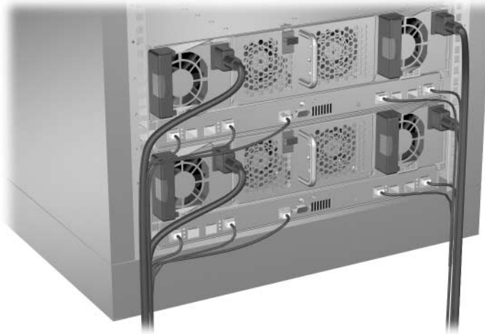
インターコネクト スイッチを使用するソリューションの配線
