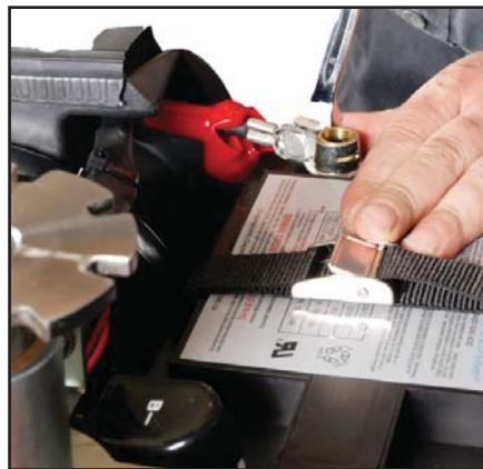
Montera av + polen på det ena batteriet
