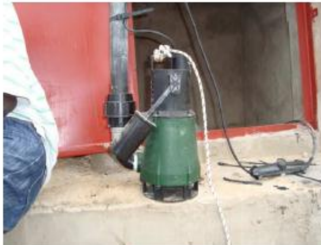
Crépine de la pompe solaire
