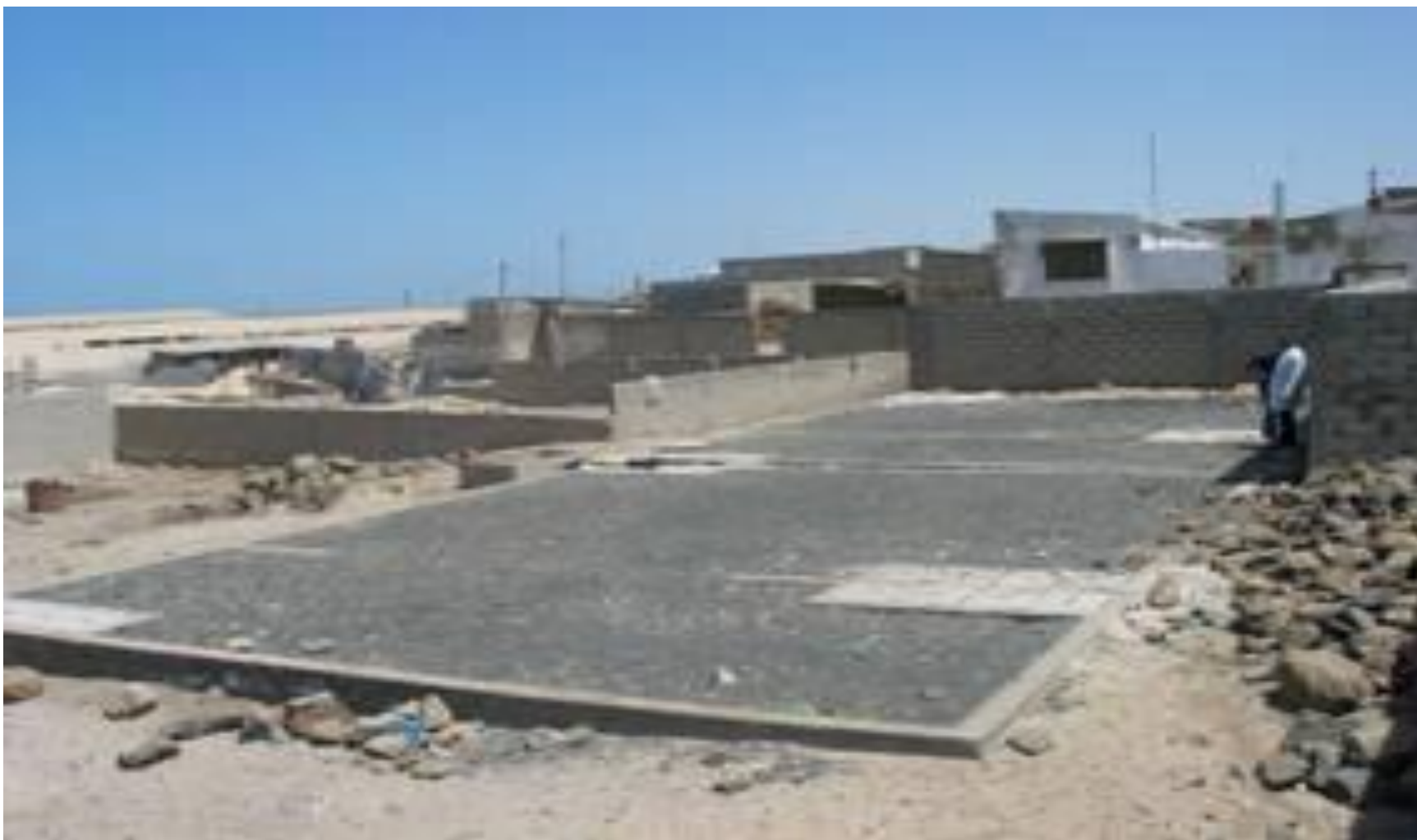
Station d'épuration à Yoff, Dakar, Sénégal © Enda
