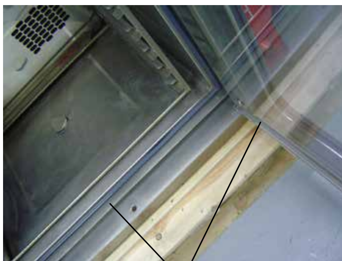
Goulottes de récupération des condensats
