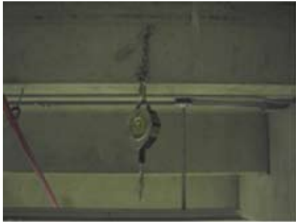
Figure H-10. Cordage rétractable fixé au-dessus de l'échelle. Cette installation simplifie le montage de protection antichutes et remplace l'évaluateur qui, autrement, devrait assurer l'aspirant.
