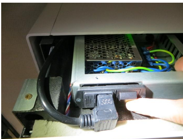
Figure 10: Interrupteur de l'UTA sur ON
