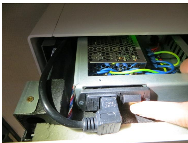
Figure 2: Mise en route de l'UTA
