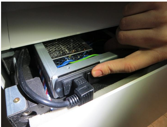
Figure 5: Interrupteur de l'UTA sur OFF
