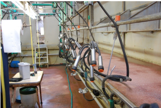
La salle de traite doit être en configuration de 'Test à sec' pendant le 'Test Chute Faisceau'
