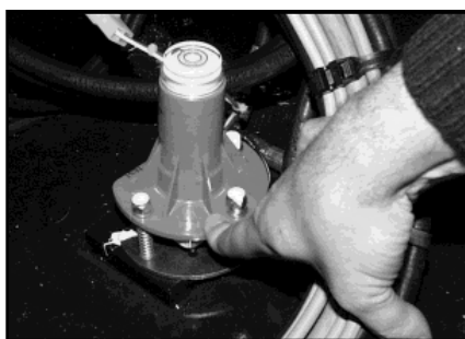
Fig 5.7. - Test détecteur de dévers
