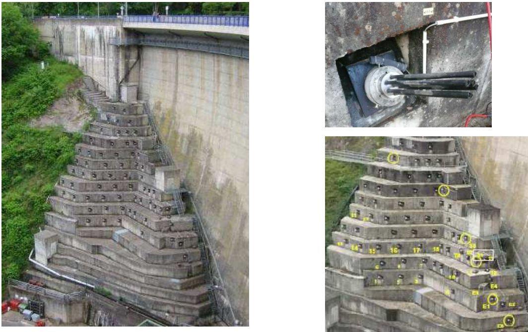
Figure 8 : Barrage d'Esch-sur-Sûre (Luxembourg). Reinforcement de la rive droite (1992-1993) Repérage des 6 tirants auscultés (cercles jaunes)
