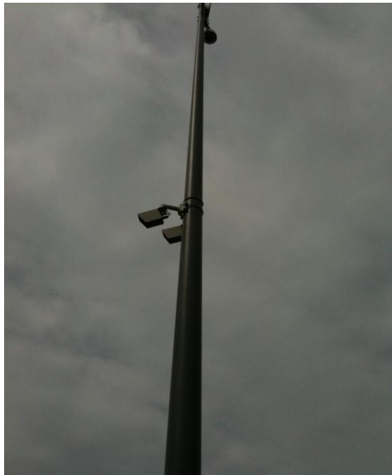
Deux capteurs installés sur un candélabre en latéral
