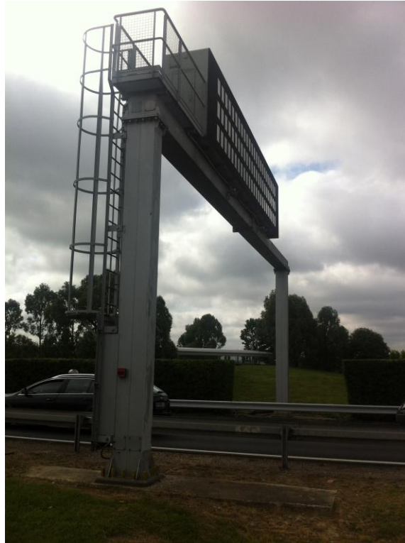
Deux capteurs installés en portique
