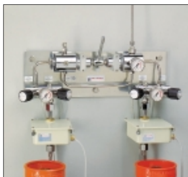
Réchauffeur LRX①* sur centrale gaz CLSA
