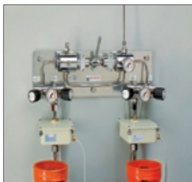
Réchauffeur LRX ①* sur centrale gaz CLSA
