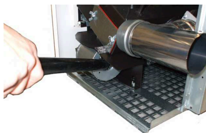
Fig. 63 - Nettoyage de le ventilateur ambiant
