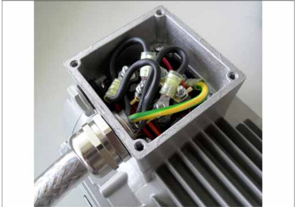
Câblage sur le boîtier de raccordement du moteur
