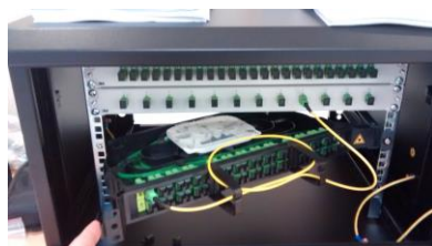
Vue de la baie de brassage SRO incluse dans FF12 (Déploiement horizontal)
