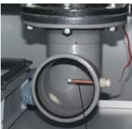
Sonde de température des fumées dans coude en plastique
