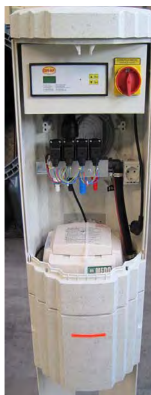
Vue de l'armoire de pilotage externe avec le capot ouvert.
