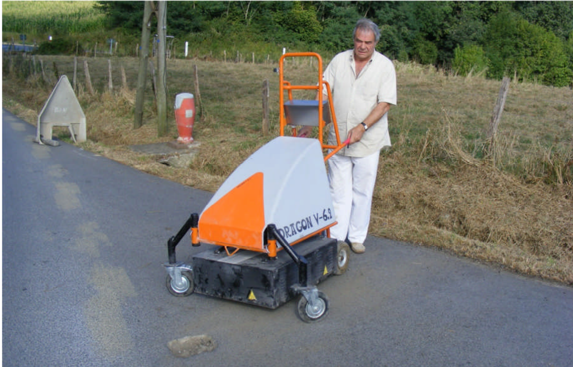
Daniel BANCON, à l'origine du projet, sur chantier réel de réparation de l'enrobé.
