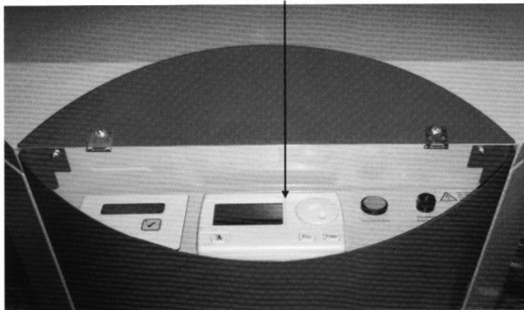
Régulation de chauffage
