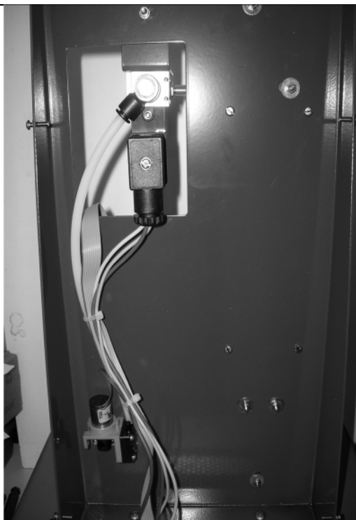
Fig. 6 : détail de l'électrovanne et de la pompe.
