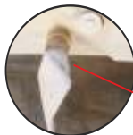
Canalisation d'évacuation du jus d'ordure
