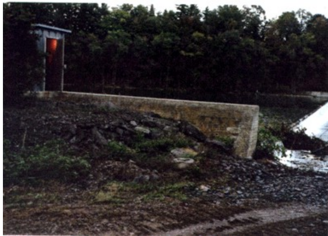
Figure 1. Grand déversoir en paroi mince, rivière Trent aux chutes
