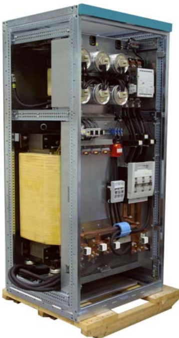
Figure 3-13 Armoire CA SINVERT 350 ou SINVERT 420
