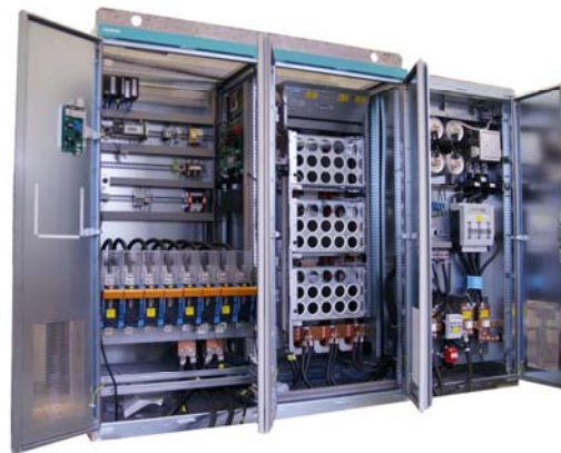
Figure 2-3 SINVERT 420 M, portes ouvertes
