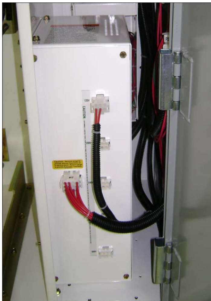
Figure 14. Bornes de sélection de transformateur (connectées à la prise 120 V c.a. sur l'illustration).
