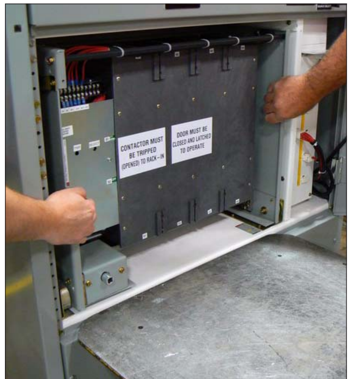
Figure 6. Dispositif de commutation à débrogage entièrement déployé à partir des retours du commutateur de transfert.
