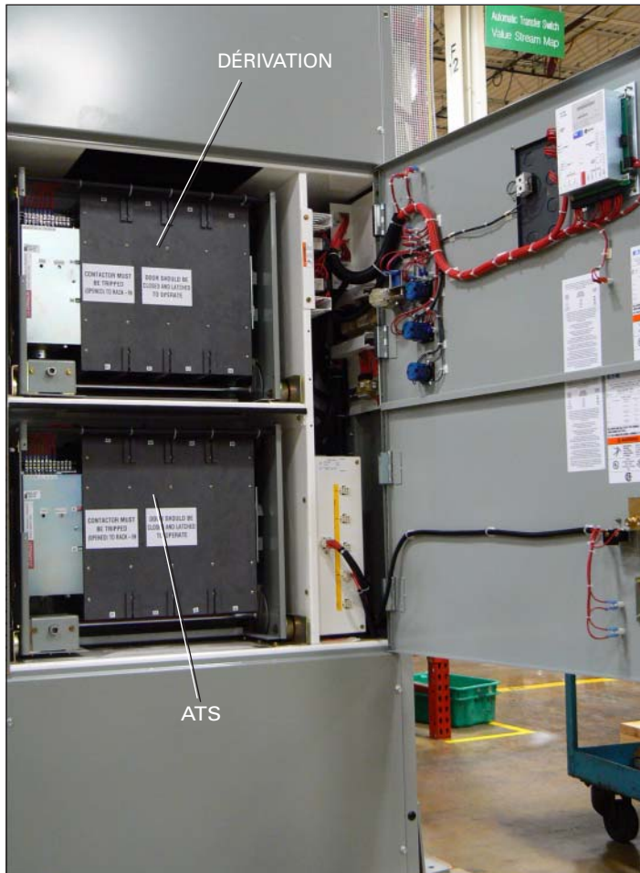
Figure 5. Dispositifs de commutation installés dans le commutateur de transfert.
