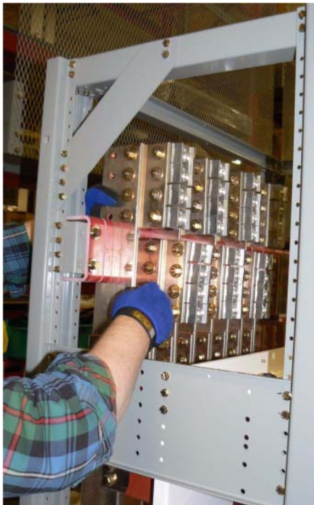
D. Réinstallez l'extension en cuivre.
