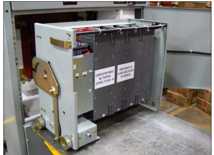
Figure 44. Contacteur sorti (en le faisant rouler) des rails de la cellule.
