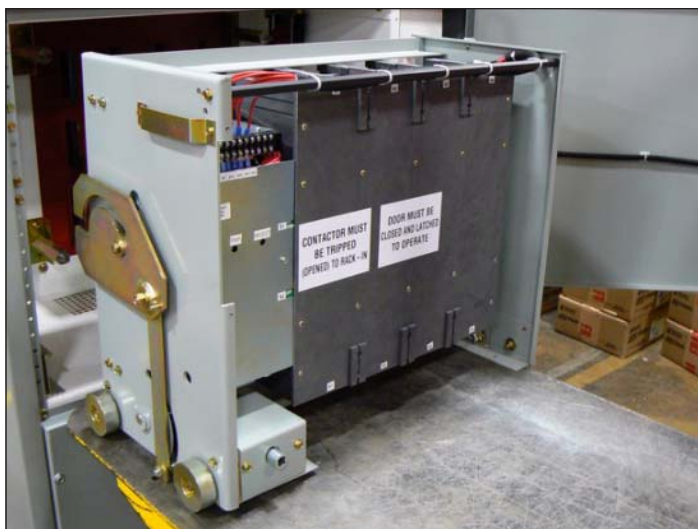
Figure 36. Contacteur retiré (en le faisant rouler) des rails de la cellule.
