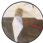
Canalisation d'évacuation du jus d'ordure
