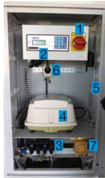
Figure 6: Vue intérieure Armoire-A
