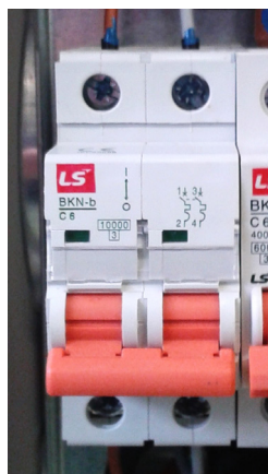
Figure 11 : Magnétothermique bipolaire du circuit d'alimentation du régulateur
