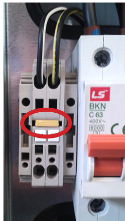
Figure 10 : Pont pour court-circuiter le secondaire du transformateur de courant (TC)
