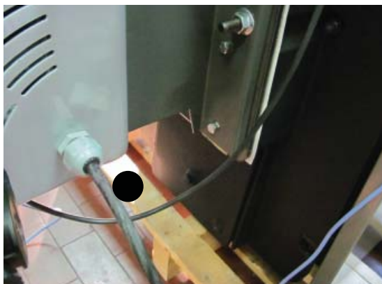
Fig. 37 Conexión a la red eléctrica
