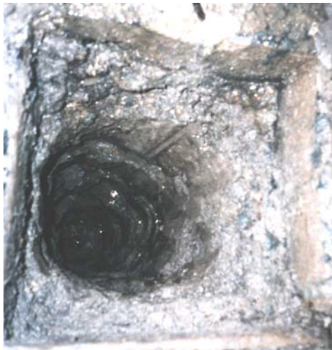
Figura 27. Pozo de puesta a tierra de cámara subterránea.
