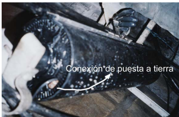
Figura 6. Conexión a tierra en el manguito de cámara
