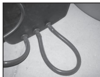
Sorties non utilisées branchées à la tuyauterie
