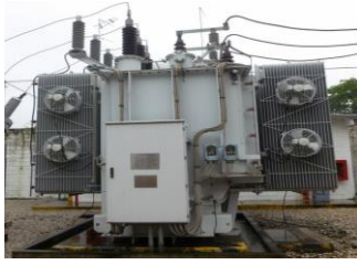
Figura 2. Transformador de Potencia de la S/E Cerro Blanco, marca ABB.
