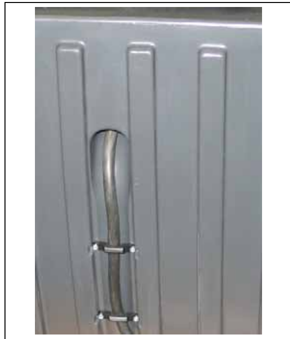
Fig. 6: Descarga de tracción: abrazaderas de descarga de tracción en el exterior del separador de líquidos
