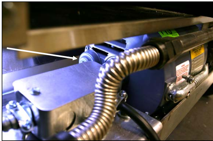
Interruptor de restablecimiento de la bomba del filtro (flecha)
