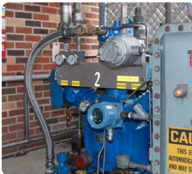
Protección a compresores de gas
