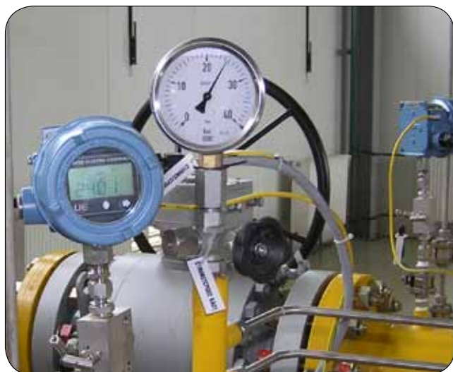
Apagado de emergencia de bombas
