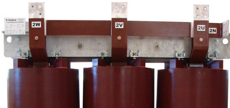
Vista de la conexión de Baja Tensión
