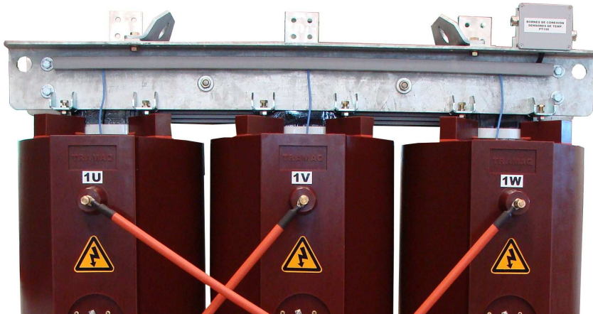
Vista de la conexión de Alta Tensión
