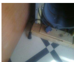
Toma de entrada de corriente del quemador
