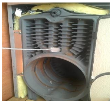
Cómo se limpia una caldera
