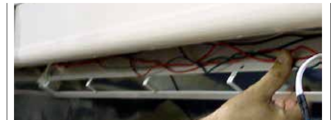
Acceso a las balastras del toldo y los estantes
