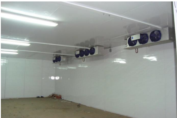
Cuarto frío vista interior...Construido en el Salvador. C.A
