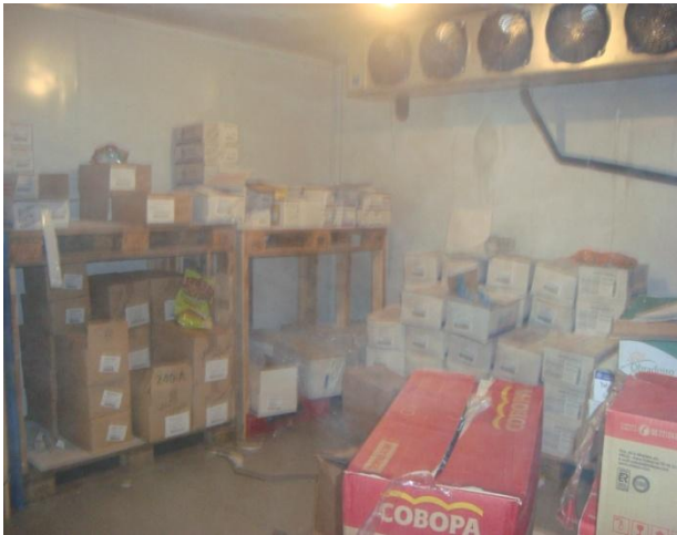
CUARTO CONGELADO FUNCIONANDO.
