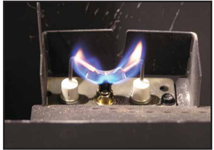
Figura 3.1 Aspecto de las llamas de un piloto IPI
