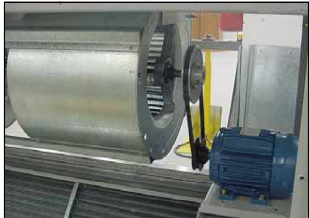
Picture 7 – Fan motor
