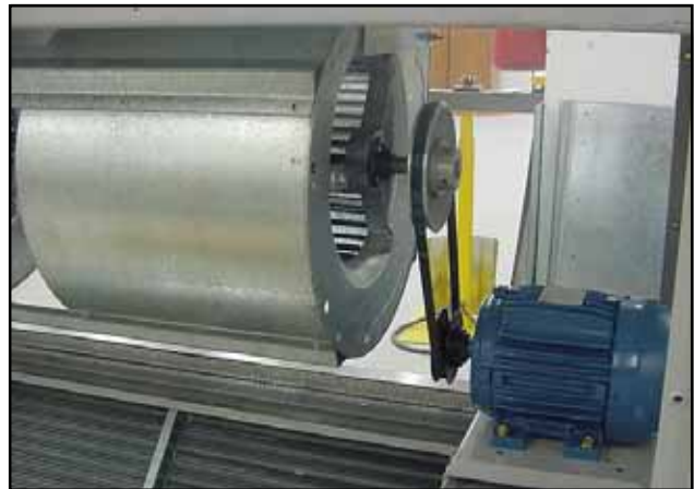
Figura 7 - Motor del ventilador
