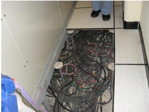
Fuente: Elaboración propia Fotografía 19: Parte del cableado a retirar
