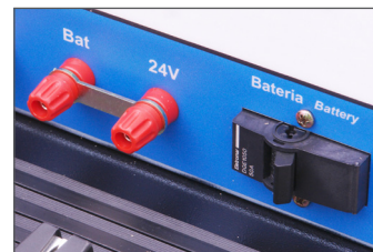
Puente de Conexión / Interruptor de la Batería
