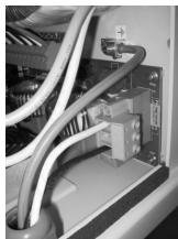
Figura 3.5.1: Cableado de CA
