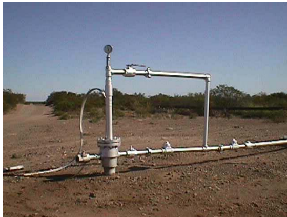
Figura No. 91 Verificación del Puente de Producción
