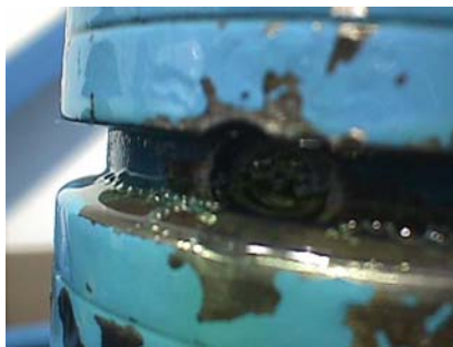
Figura No. 61 Comprobando Apertura de Válvulas de Retención
