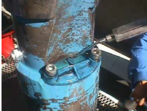
Figura No. 79 Limpieza del área del pothead del motor con aceite CL5
