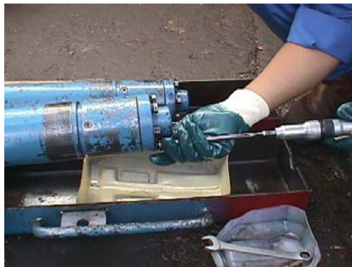
Figura No. 22 Extracción de tapa de despacho
