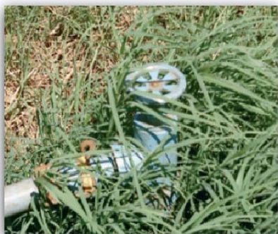
Fig.59. a. Hidrante no protegido
