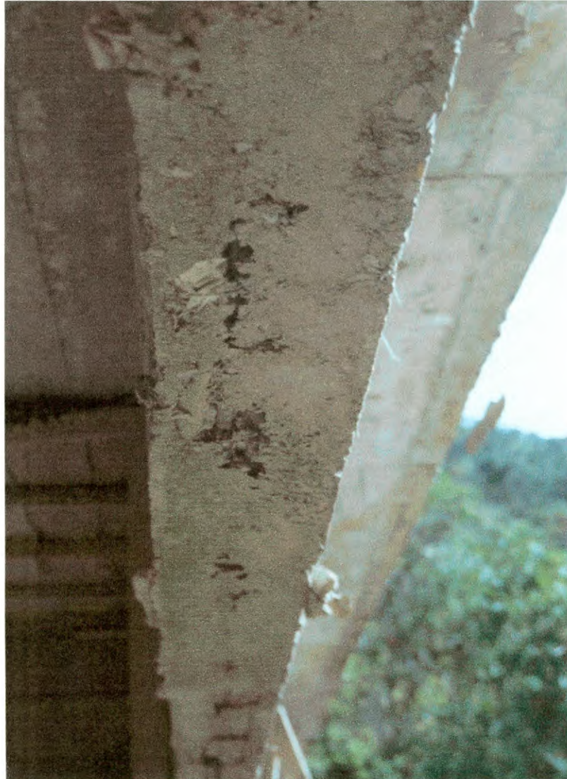
Foto 21 – Presencia de escombros de obra en la viga
