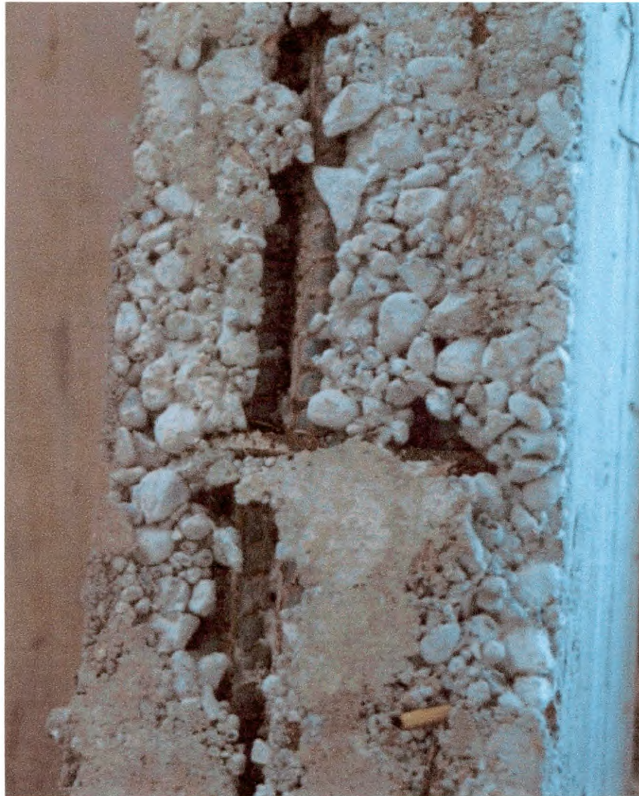
Foto 18 – Concreto deficientemente compactado y colocado
