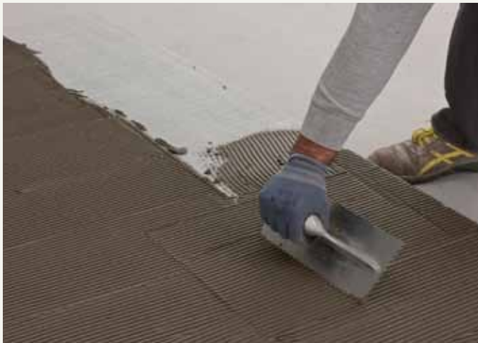
fig.36 /Extensión del adhesivo sobre el reverso de la placa. /Aplicação da cola na parte posterior da placa.
