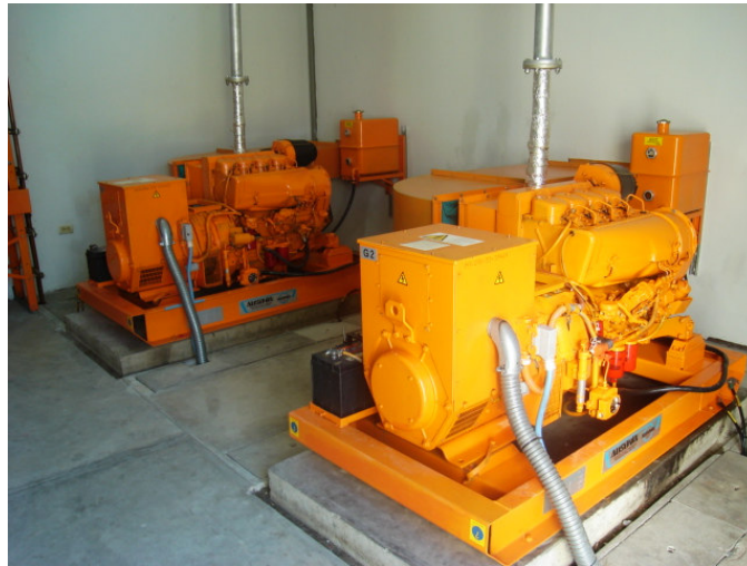
Figura 32. Grupo electrógeno dual.
