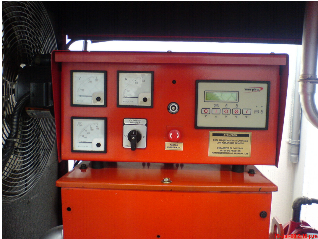
Figura 28. Grupo electrógeno con módulo de control Murphy AS731.
