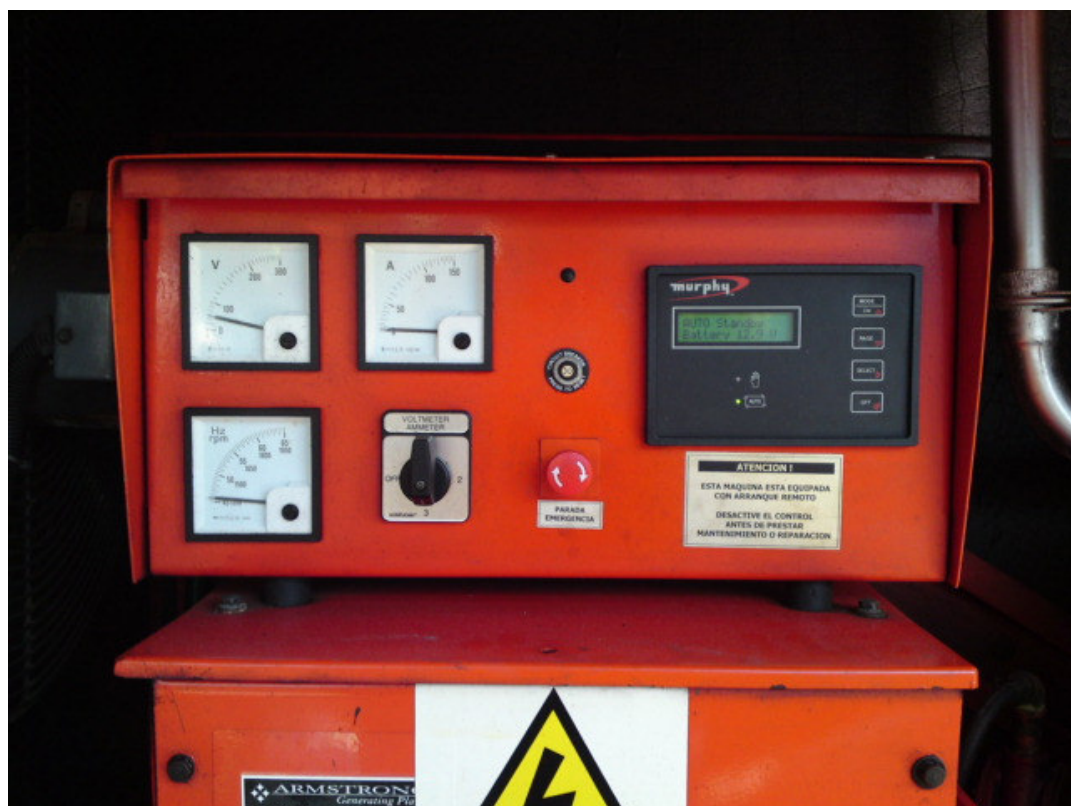
Figura 27. Vista del módulo de control Murphy AS730S.
