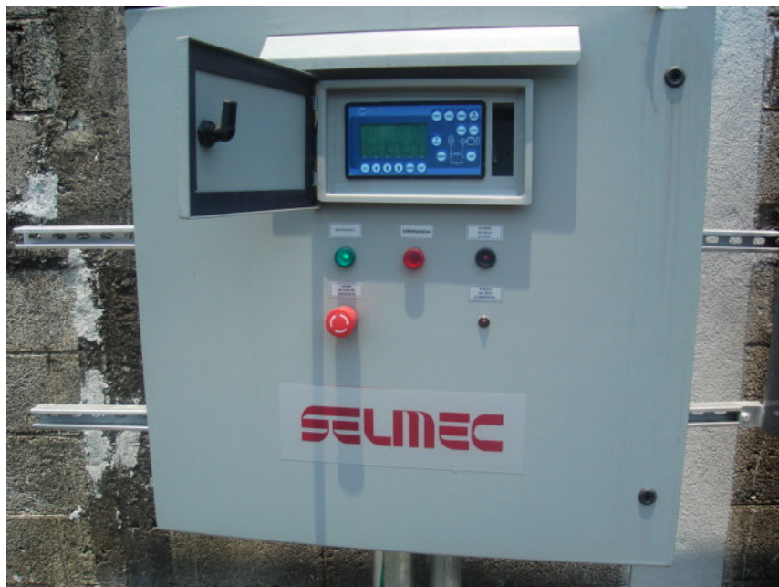
Figura 30: Tablero de grupo electrógeno con módulo de control Tecnoelettra TE-804.
