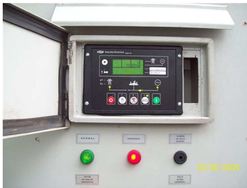
Figura 31. Tablero de grupo electrógeno con módulo de control Deep Sea Electronics 720
