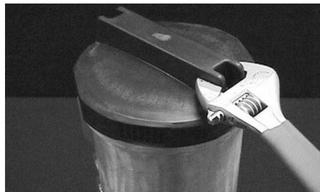
Retiro de filtro final de combustible
