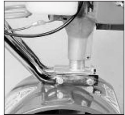
Ilustración 1 Nótese cómo el motor no está apoyado totalmente sobre la transmisión helicoidal.
