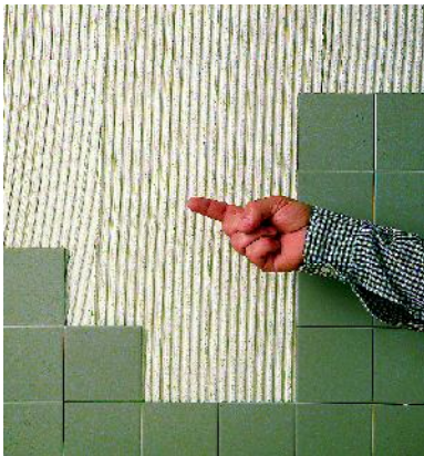
Cemento seco: no es correcto.
